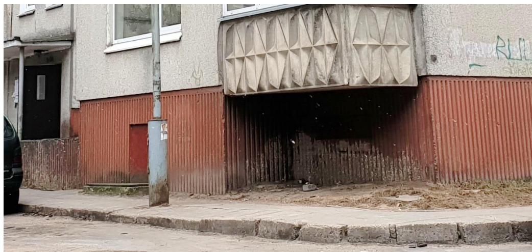
Pav. 14. Pastato cokolio būklė
