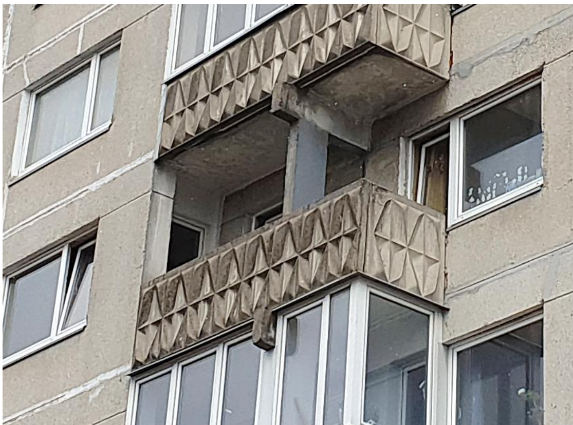
Pav. 17. Balkonų būklė
