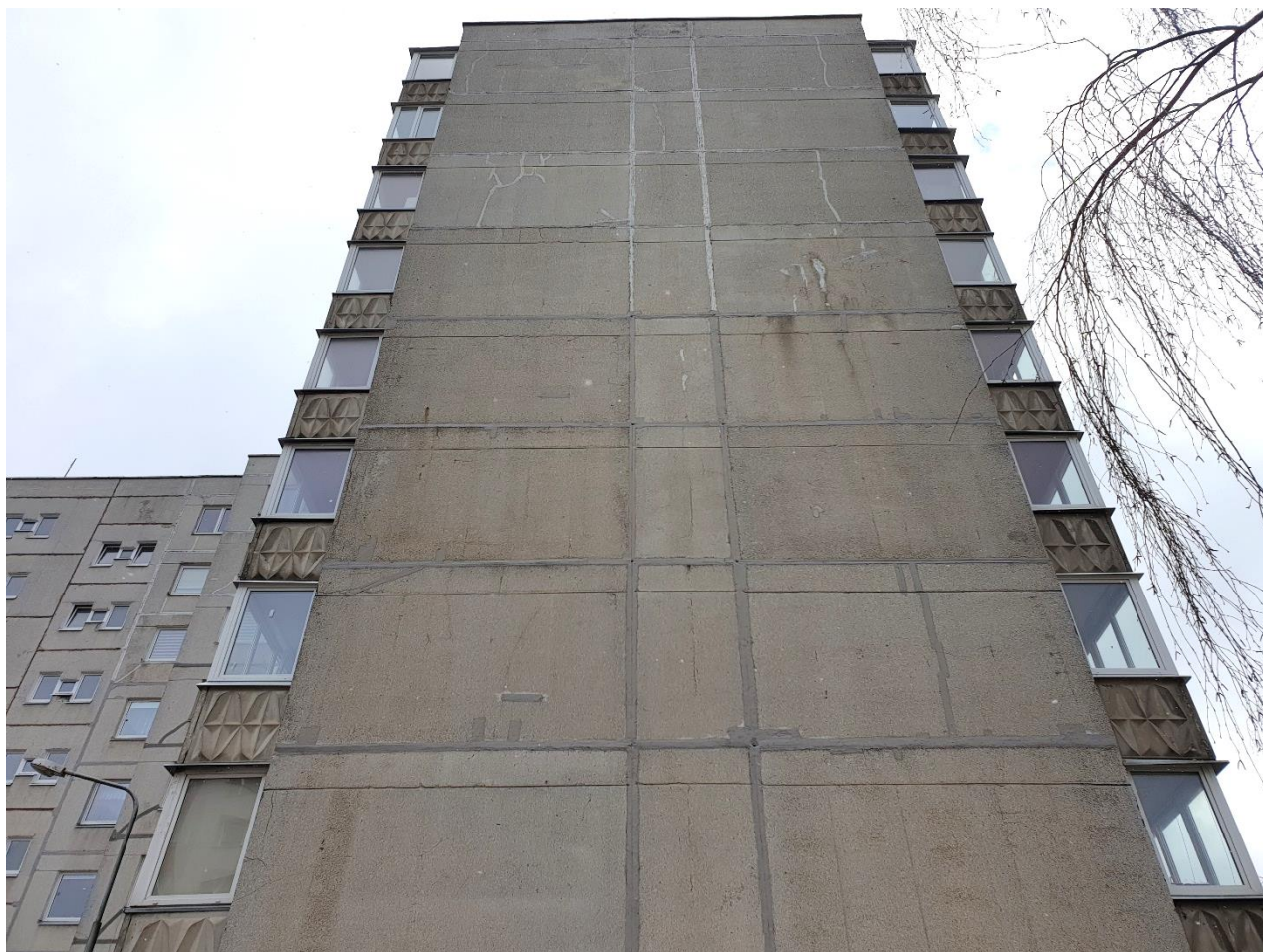
Pav. 15. Išorinės sienos būklė
