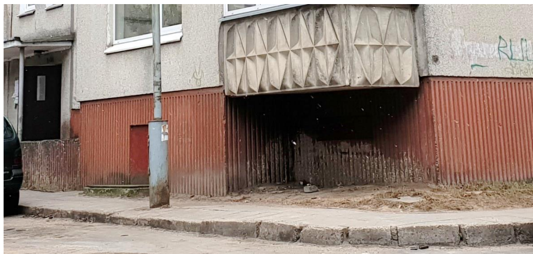
Pav. 14. Pastato cokolio būklė
