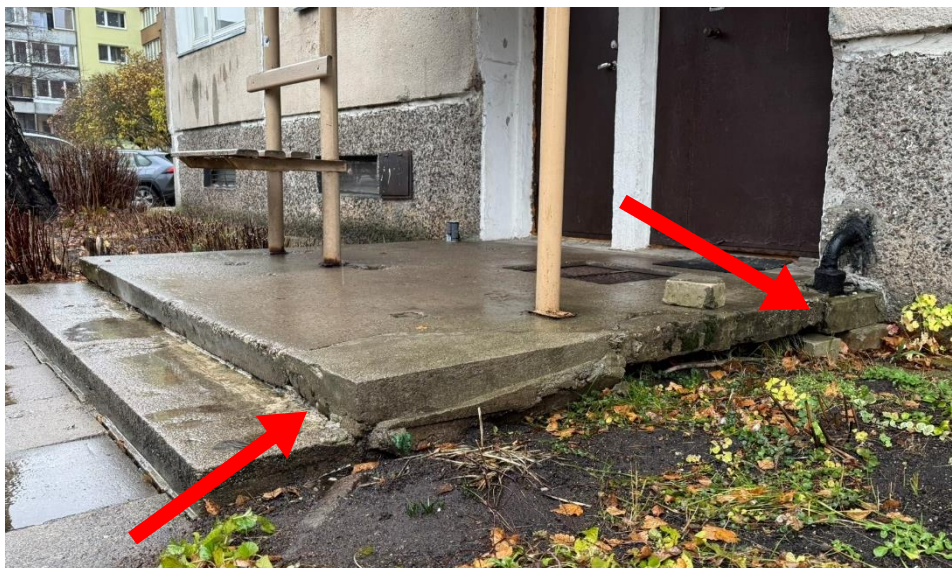
Pav. 17. Įėjimo defektai: aptrupėjęs betonas
