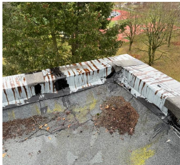
Pav. 14. Stogo defektai: apskardinimas pažeistas korozijos
