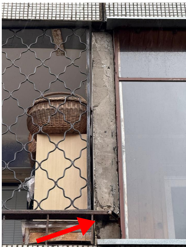
Pav. 19. Balkonų defektai: apskilinėjęs betonas
