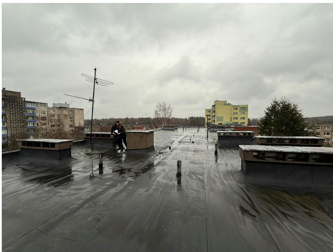
Pav. 12. Bendra stogo būklė
