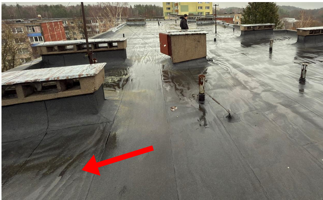
Pav. 15. Stogo defektai: pūslėta danga
