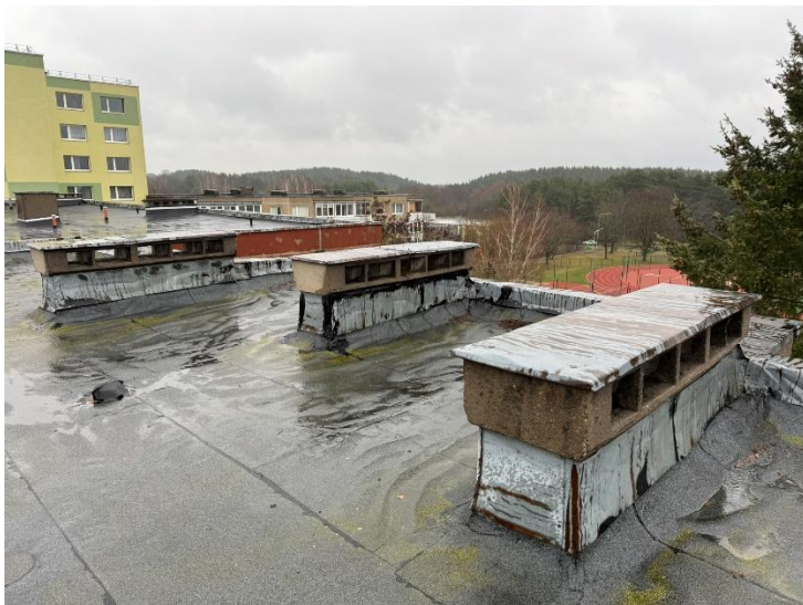
Pav. 13. Stogo defektai: apskardinimas pažeistas korozijos
