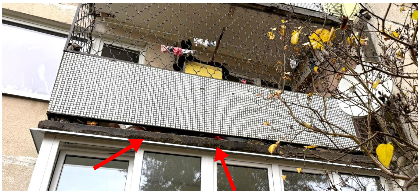
Pav. 18. Balkonų defektai: apskilinėjęs betonas
