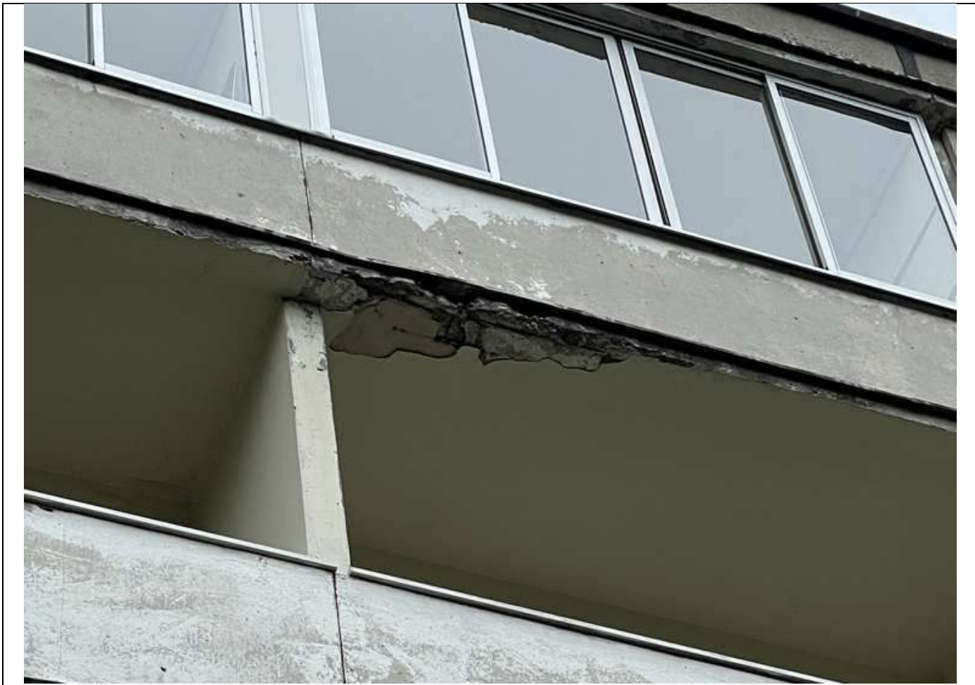
5 pav. Pažeista balkono plokštės briauna, atvira armatūra
