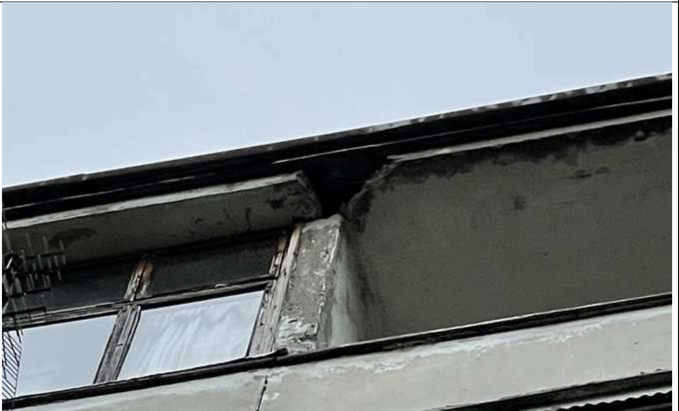
6 pav. Nuskilęs balkono plokštės kampas
