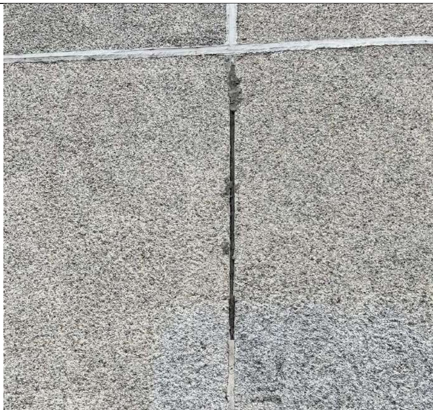
3 pav. Ištrupėjusios siūlės
