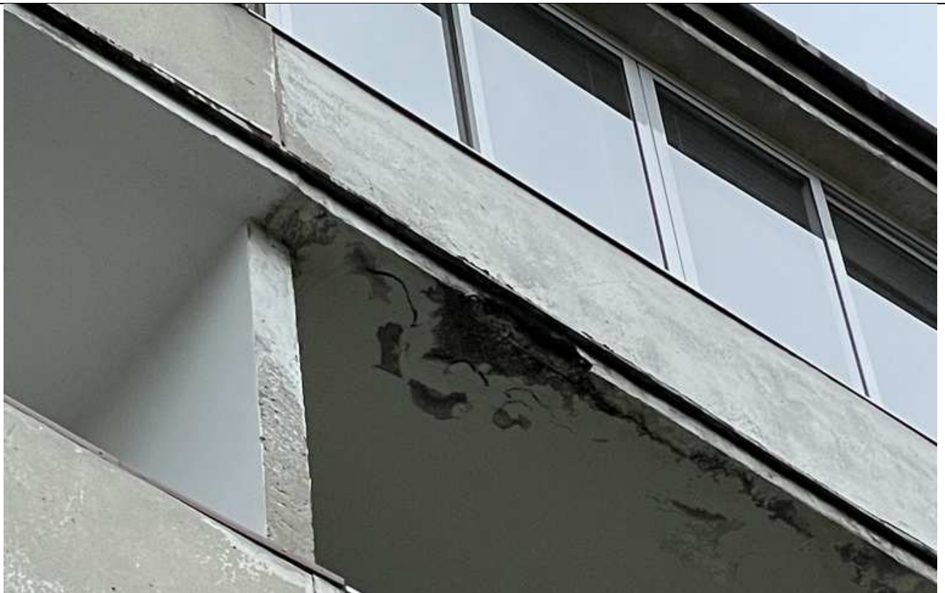
7. pav. Pažeista balkono plokštės briauna, atvira armatūra
