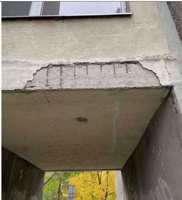
1 pav. Virš praėjimo esančios sijos atvira armatūra
