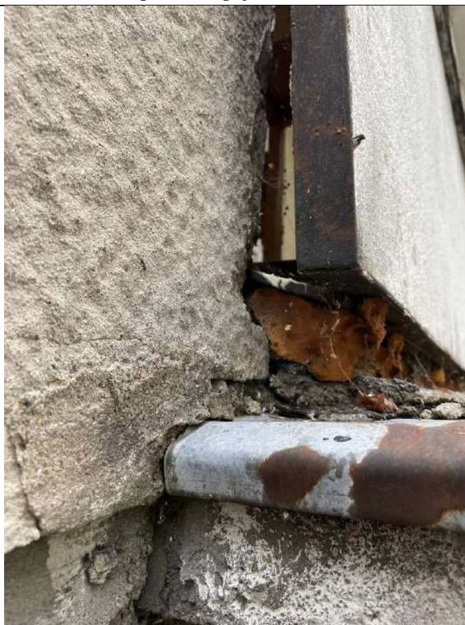
4 pav. Balkono aptvaras su korozijos paveiktu aprėminimu ir tvirtinimo detalėmis
