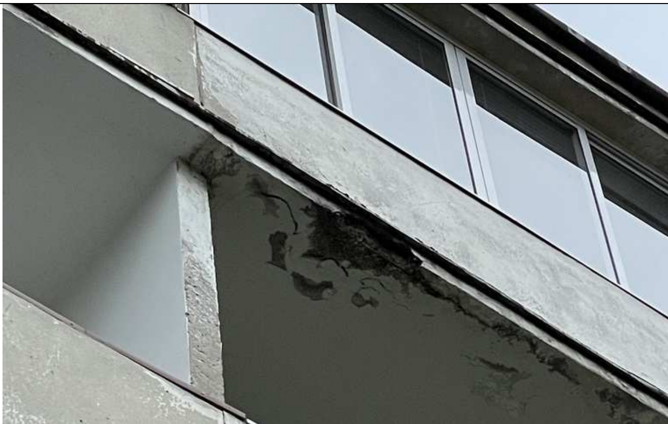
7. pav. Pažeista balkono plokštės briauna, atvira armatūra
