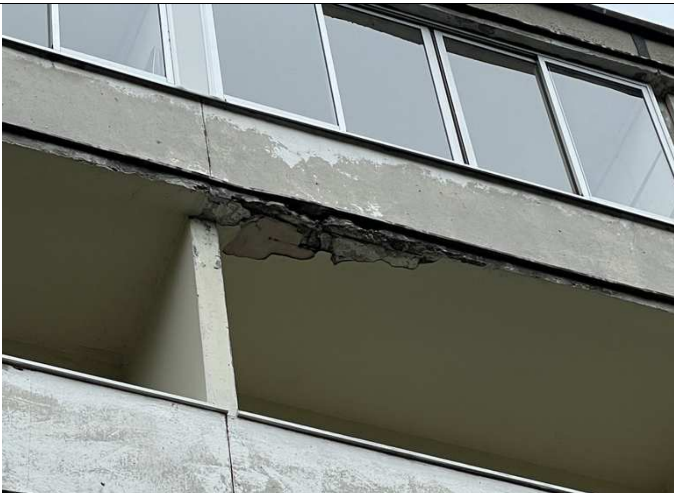
5 pav. Pažeista balkono plokštės briauna, atvira armatūra
