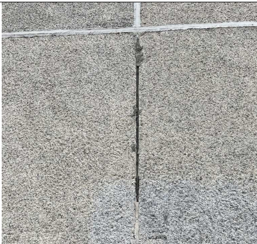
3 pav. Ištrupėjusios siūlės
