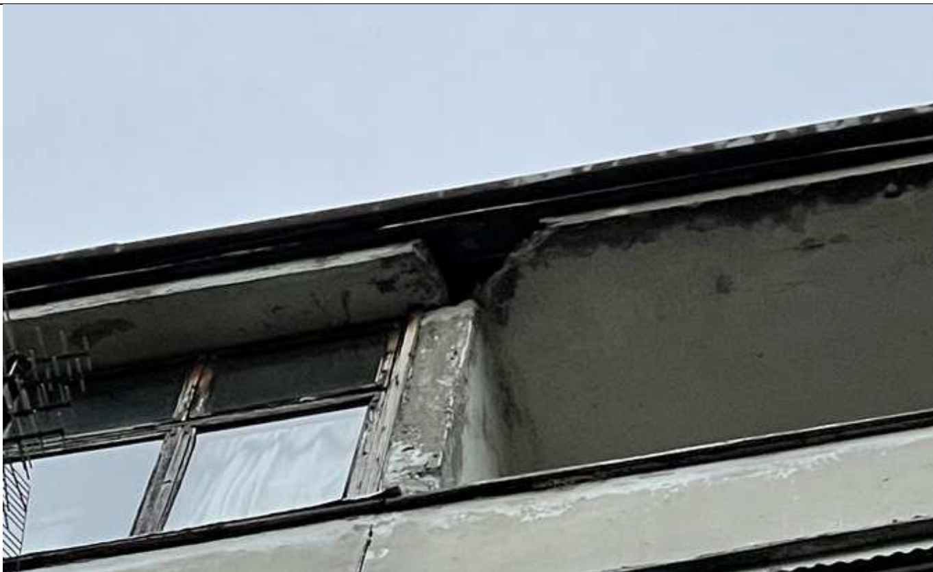
6 pav. Nuskilęs balkono plokštės kampas
