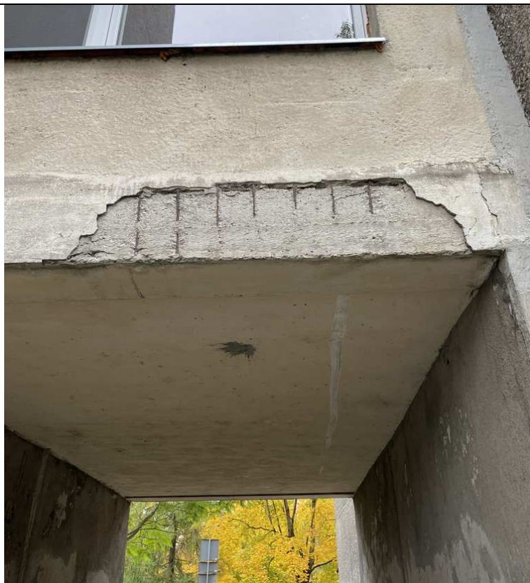
1 pav. Virš praėjimo esančios sijos atvira armatūra
