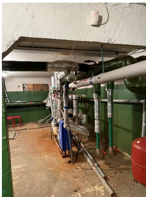
Pav. 20. Komunikacijų vamzdinių būklė
