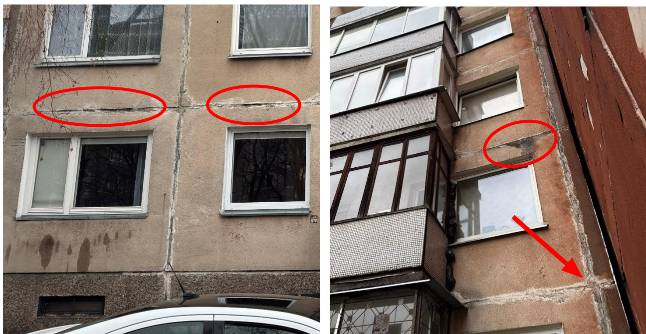
Pav. 11. Sienų defektai: dalinai nesandarios siūlės
