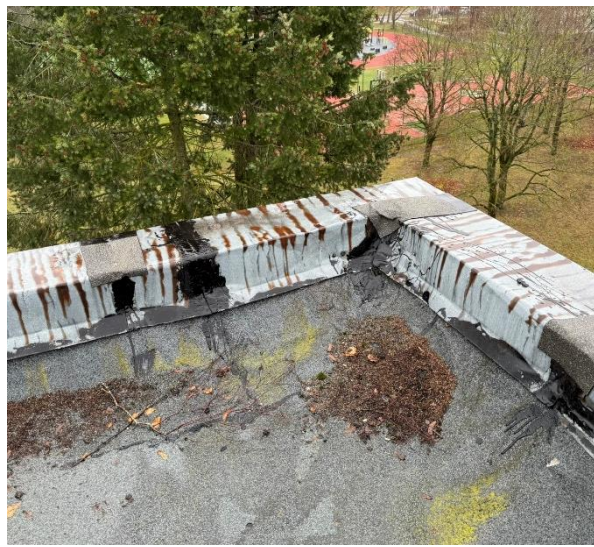
Pav. 14. Stogo defektai: apskardinimas pažeistas korozijos
