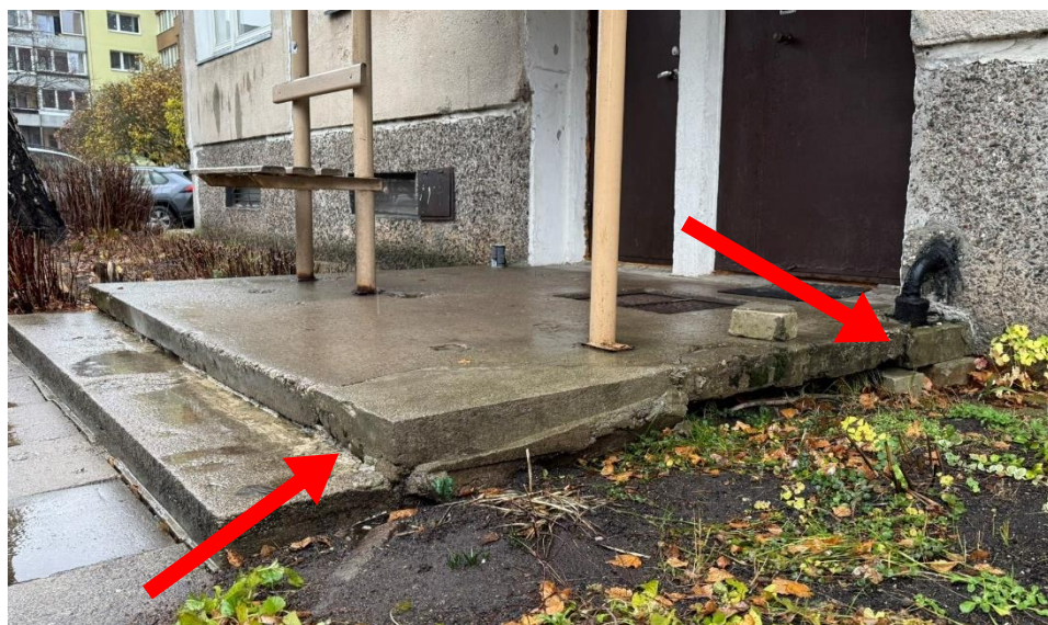
Pav. 17. Įėjimo defektai: aptrupėjęs betonas
