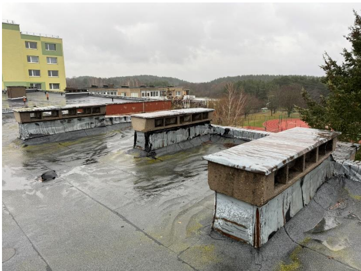
Pav. 13. Stogo defektai: apskardinimas pažeistas korozijos
