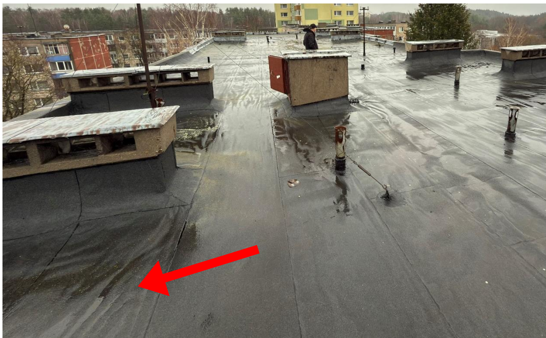
Pav. 15. Stogo defektai: pūslėta danga
