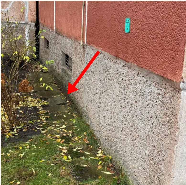
Pav. 10. Nuogrindos defektai
