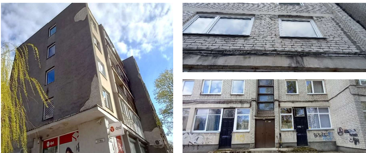
3 pav. Nusidėvėjęs fasadas – išorinių sienų (iš gatvės pusės) tinkas ties pastato kampu, langais, balkonais, atšokęs, silpnai laikosi, vietomis nubyrėjęs; išorinių sienų (iš kiemo pusės) mūro siūlės ištrupėjusios. Fasade matomi įtrūkimai. Fasadu nutekantis kritulių vanduo turi galimybę patekti į pastato sienų konstrukciją. Fasadas išpaisytas. Ant fasado montuojami oro kondicionieriai, antenos.
