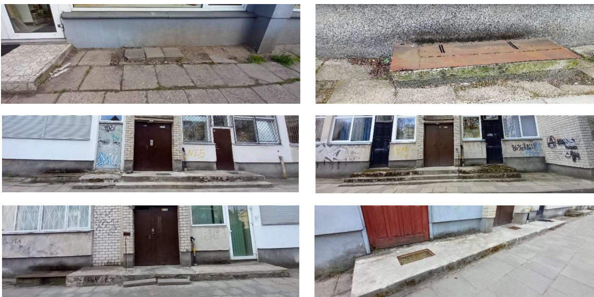
2 pav. Netvarkingos nuogrindos – įdubusios, neturi tinkamų nuolydžių nuo pastato. Cokolio tinko paviršiai pažeisti, apirę, yra įtrūkimų.
