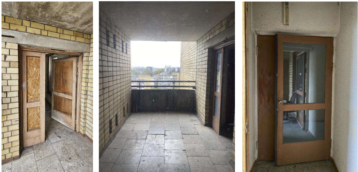
11. Pav. Durys į N1 tipo evakuacinę laiptinę netvarkingos, neatitinka gaisro saugos reikalavimų. Šalia N1 tip laiptinės balkonų, už mūro sienos su angomis yra rūbų džiovyklos.
