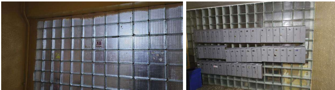
12. Pav. Liftų holai nuo koridorių aukštuose atskirti stiklo blokelių pertvaromis, pirmame aukšte ant jos įrengtos pašto dėžutės. Pertvaros atrodo tvarkingos, turėtų laikyti EI 45.
