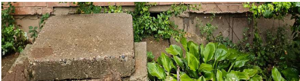
14 pav. Namo Nr. 28 vakariniame fasade ašyje A-A cokolis drėksta, cokolio paviršius be apdailos, sutrūkęs. Šioje namo dalyje įtakos deformacijų pobūdžiui turėjo ir komunikacijų kanalas.
