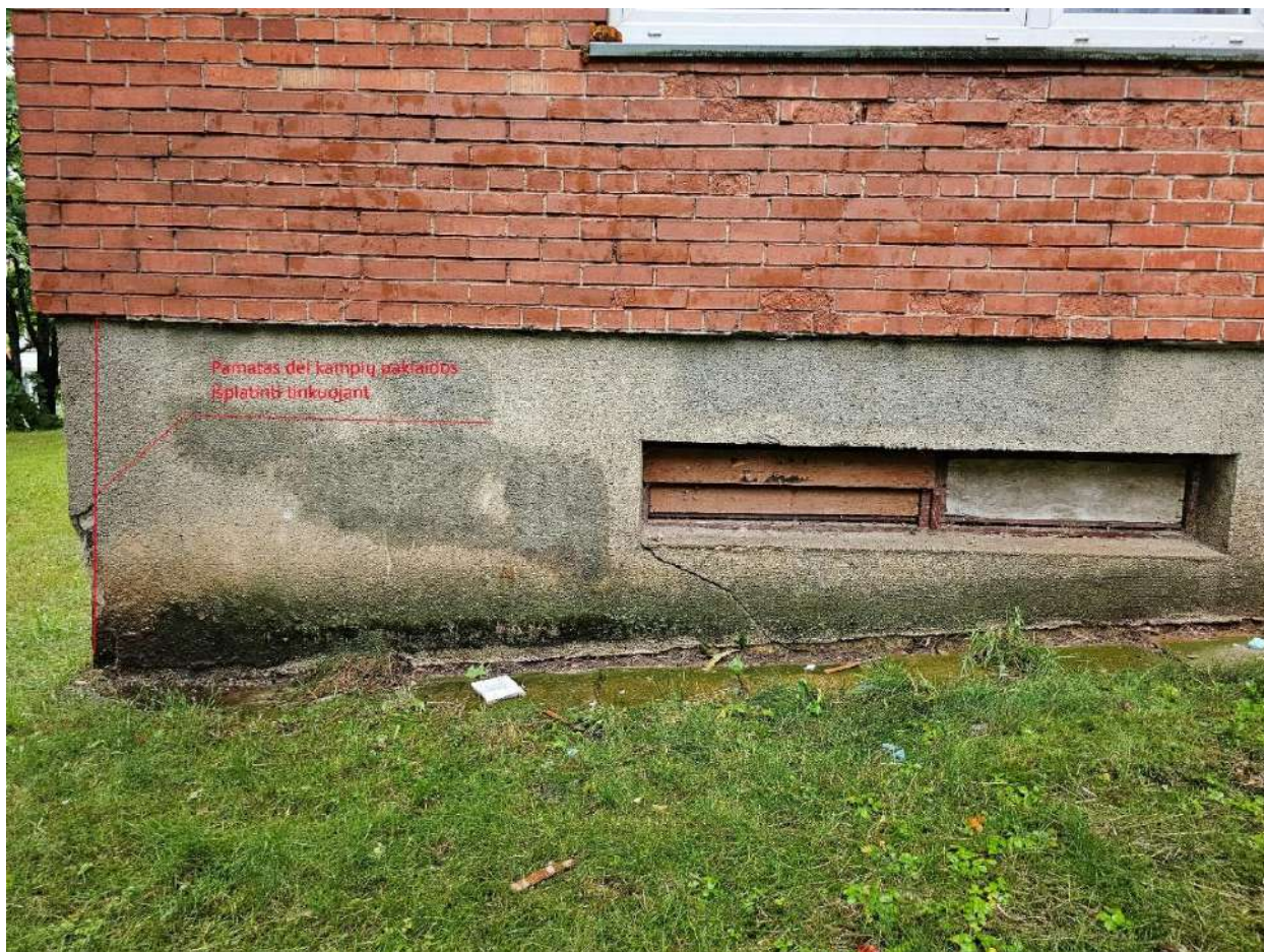
15 pav. Namas Nr.28, ašis 4 ašyje C-C, pamatas išplatintas skiediniu tinkuojant, dalinai kompensuojant kampinius nukrypimus horizontalėje (statybos defektas, įstrižainių ilgio skirtumas priešinguose kampuose).
