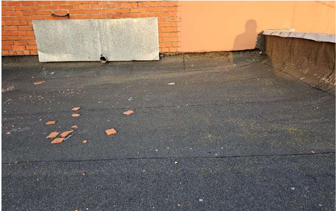
43 pav. Stogo danga prilydomoji dviejų sluoksnių, stogas remontuotas.
