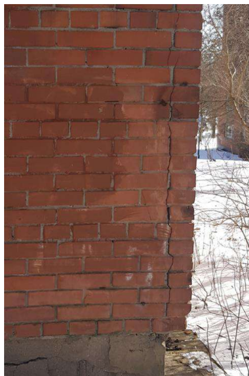
22 pav. Ašis A-A, atitrūkęs išorinis sluoksnis.
