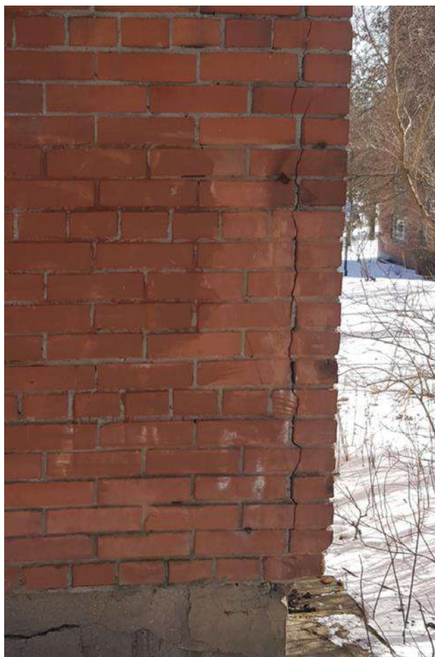
13 pav. Pastatas Nr.28, ašis 1 ašyje A-A išorinis apdailinio plytų mūro sluoksnis dėl statybos defektų montuojant pamatus (kampinių nukrypimų horizontalioje plokštumoje) sumūrytas be atramos. Analogiškas mazgas priešingoje pastato pusėje (pamatas pritinkuotas cementiniu skiediniu) tik neatitūręs 15 pav.)
