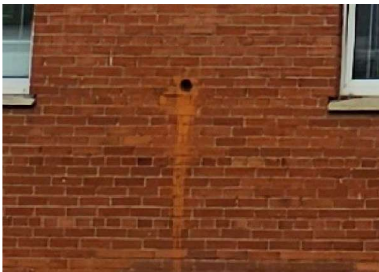
19 pav. Kerno paėmimo vieta, pastato Nr.26 vakariniame fasade, ašis A-A.
