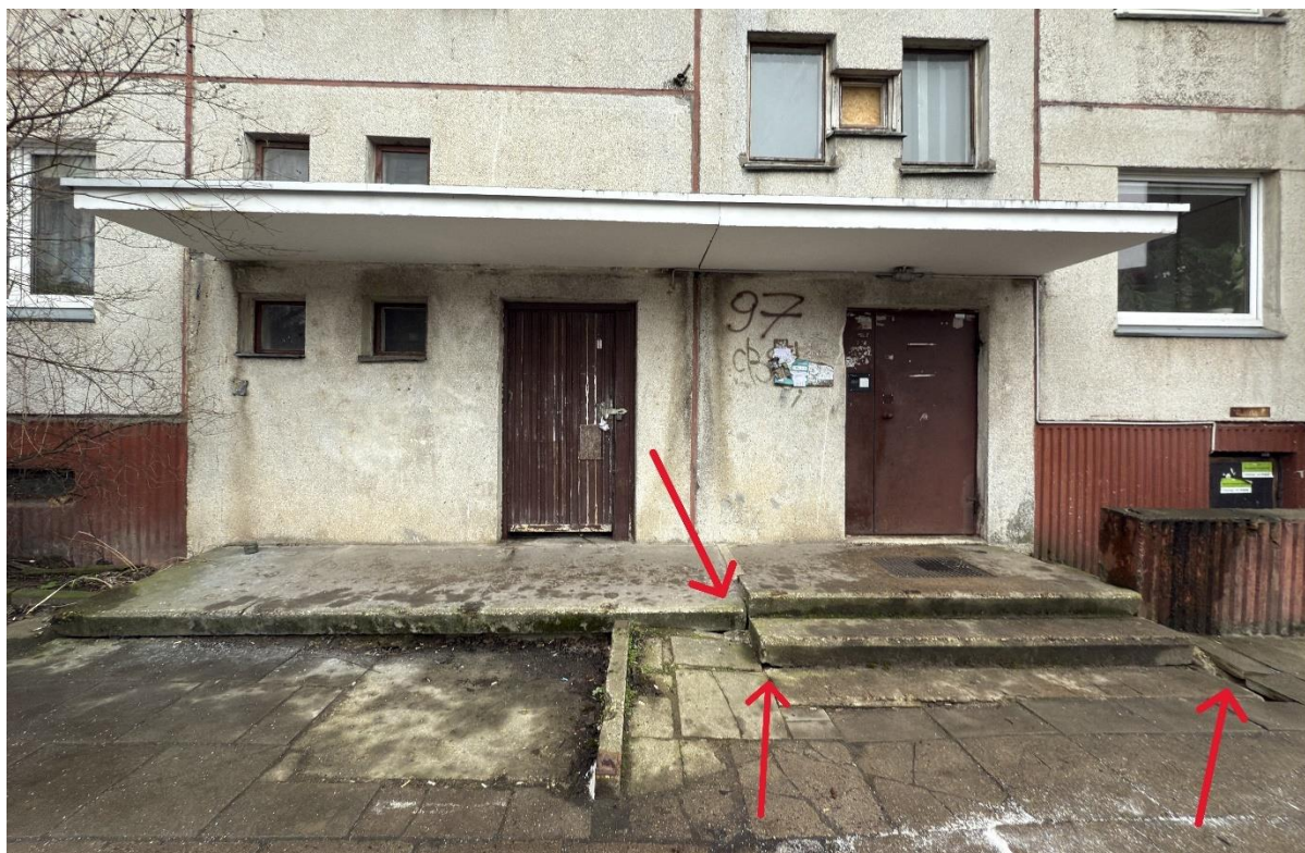
pav. 10 Laiptų aikštelės pažeidimai
