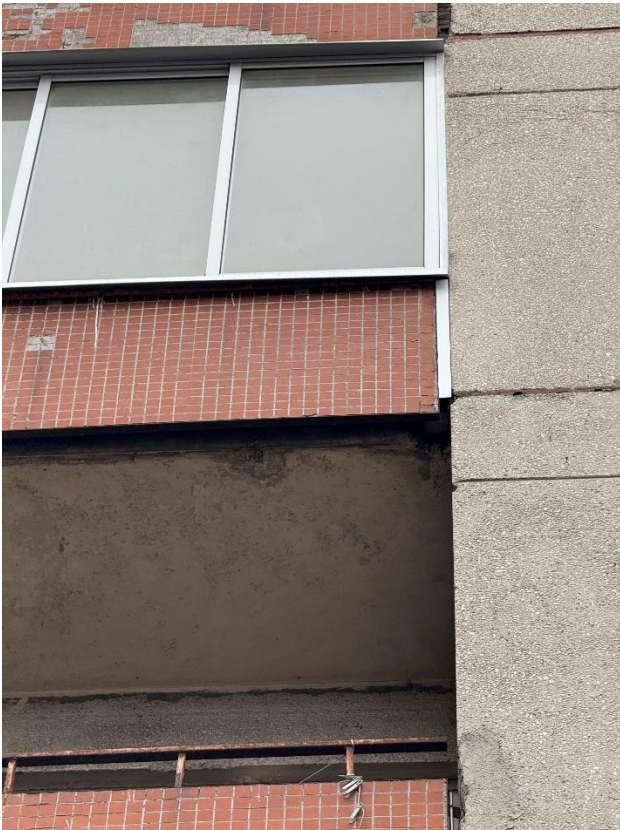
pav. 8 Balkonų būklė
