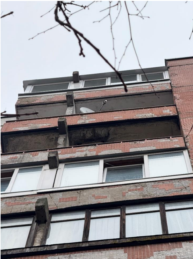
pav. 6 Apdailos plytelių byrėjimas
