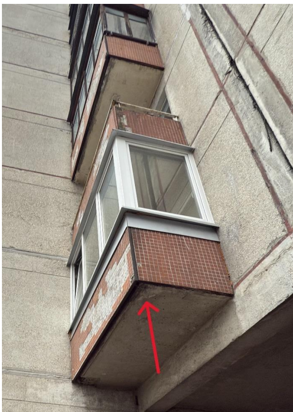
pav. 12 Balkono plokštės pažeidimai
