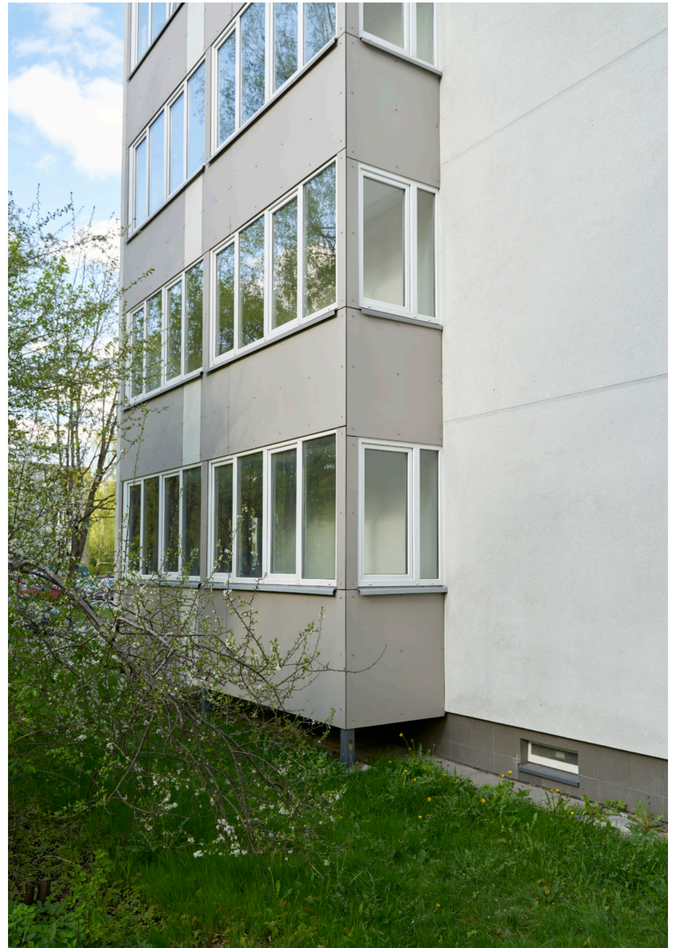
32 pav. 1-464A serijos stambiaplokščio penkių aukštų pastato balkonų apdaila fibrocemento plokštėmis, nesuvestos siūlės, netvarkingos detalės, matomas tvirtinimas, Žirmūnai, Vilnius (fot. V. Buinevičius, 2023)
