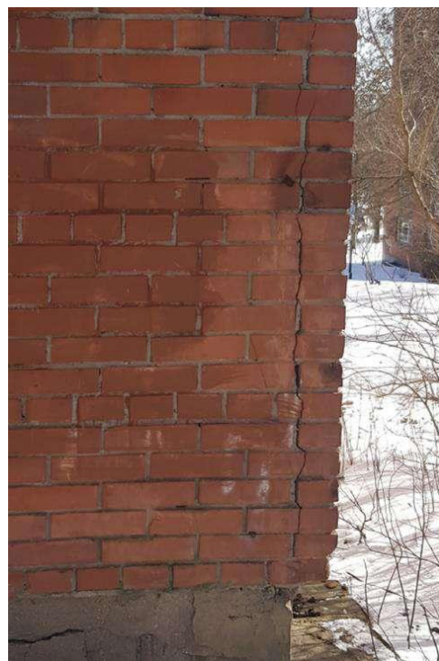
22 pav. Ašis A-A, atitrūkęs išorinis sluoksnis.
