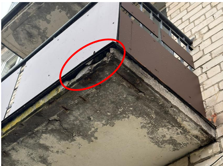
Pav. 18. Balkonų defektai: pažeistas apsauginis betono sluoksnis
