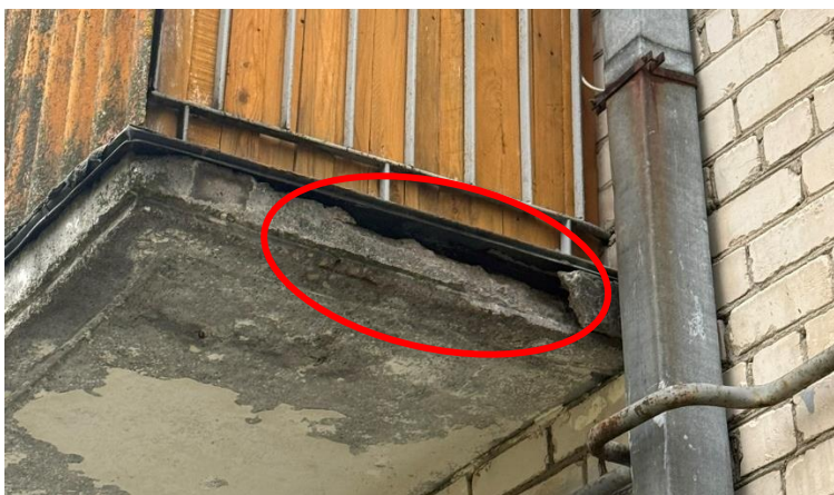
Pav. 19. Balkonų defektai: ištrupėjęs betonas
