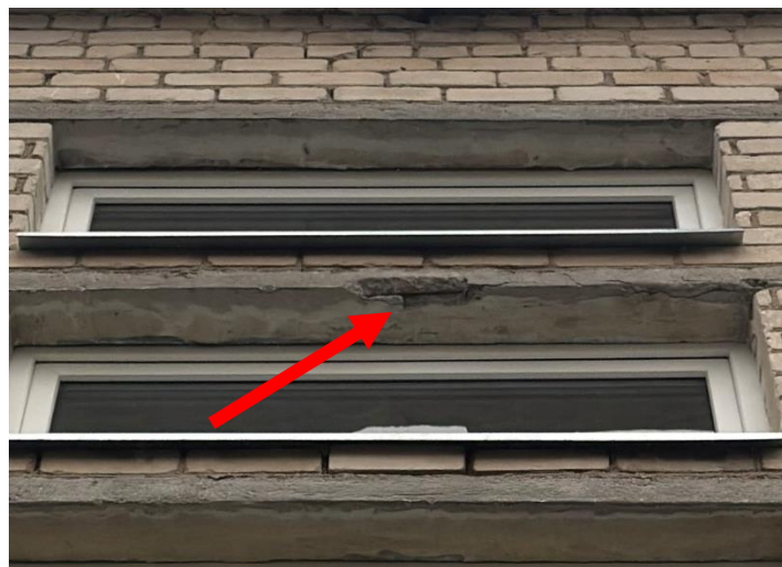
Pav. 12. Sienų defektai: pažeistas sąramos apsauginis betono sluoksnis
