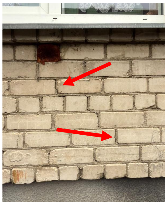
Pav. 10. Sienų defektai: vertikalūs plytų mūro įtrūkimai
