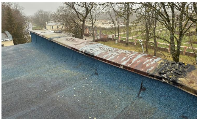
Pav. 14. Stogo defektai: apskardinimas paveiktas korozijos
