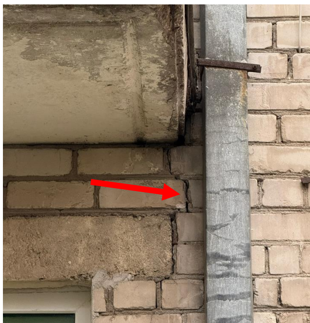
Pav. 9. Sienų defektai: vertikalus plytų mūro įtrūkimas ties sąrama
