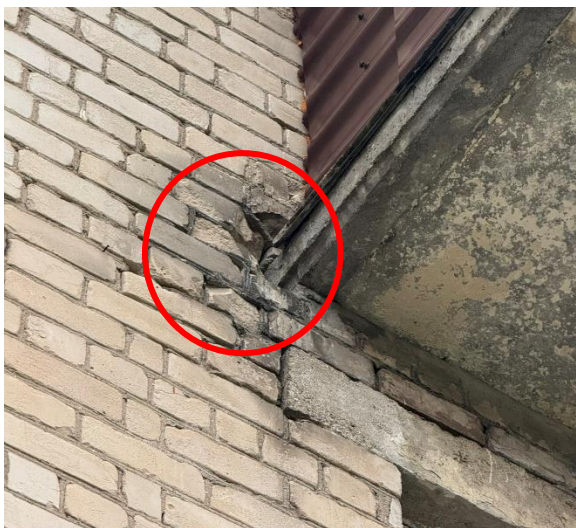
Pav. 11. Sienų defektai: ištrupėjęs plytų mūras
