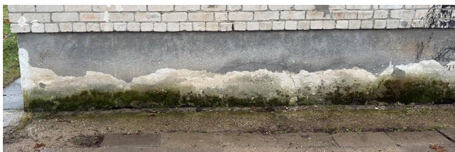
Pav. 8. Cokolio ir nuogrindos defektai
