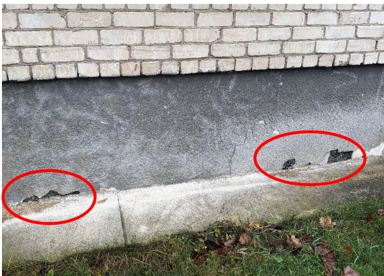
Pav. 7. Cokolio defektai
