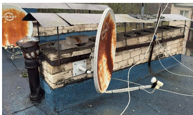
Pav. 15. Stogo defektai: prastos būklės vėdinimo šachtos
