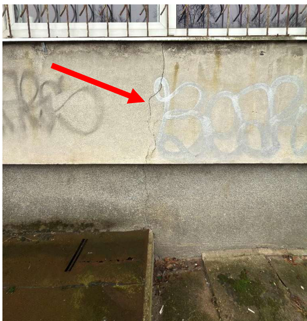
Pav. 12. Sienų defektai: vertikalūs įtrūkimai
