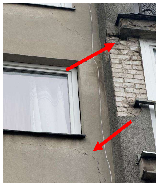
Pav. 11. Sienų defektai: vertikalūs įtrūkimai ir aptrupėjęs mūras
