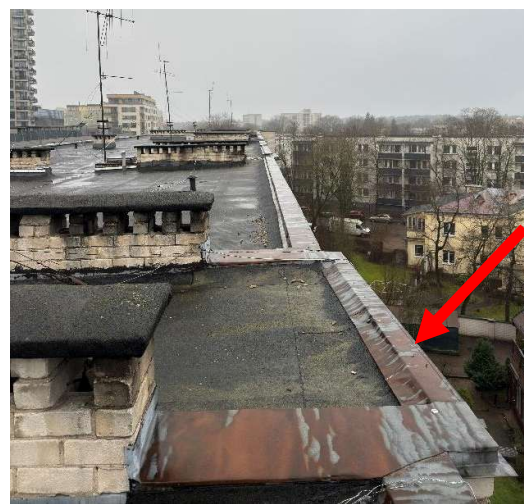
Pav. 14. Stogo defektai: apskardinimas paveiktas korozijos
