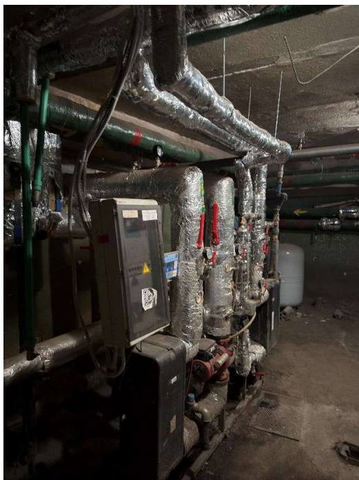
Pav. 19. Komunikacijų vamzdynų būklė
