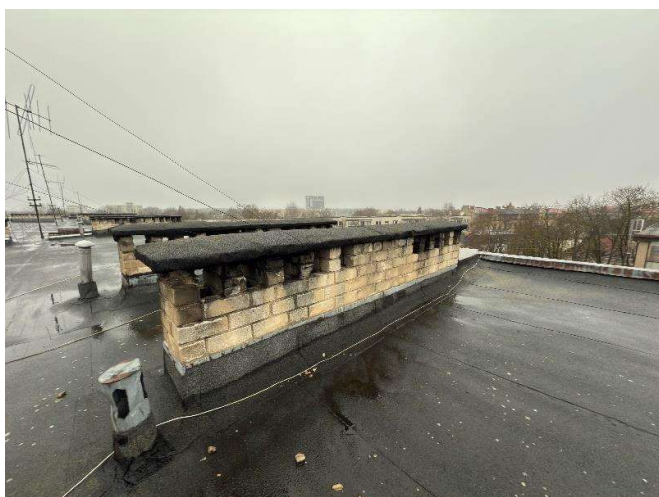
Pav. 15. Stogo defektai: neapšiltintos ir neapskardintos vėdinimo šachtos
