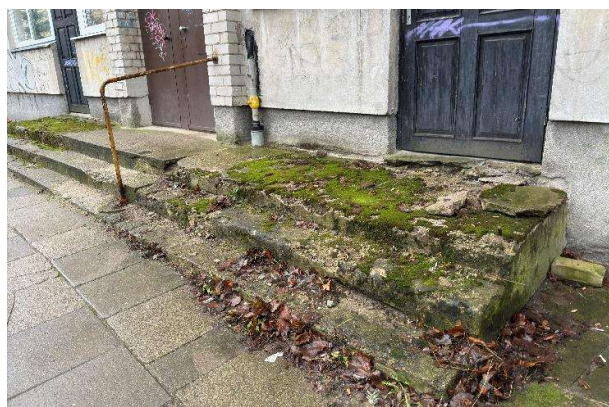
Pav. 17. Įėjimo defektai: ištrupėjęs betonas
