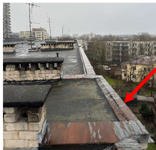
Pav. 14. Stogo defektai: apskardinimas paveiktas korozijos
