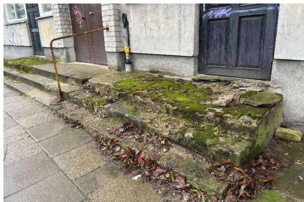
Pav. 17. Įėjimo defektai: ištrupėjęs betonas
