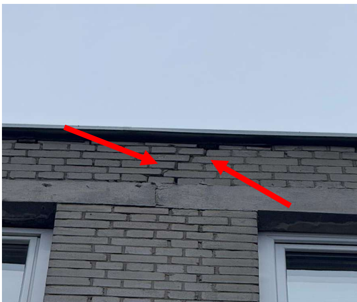
Pav. 10. Sienų defektai: vertikalūs plytų mūro plyšiai
