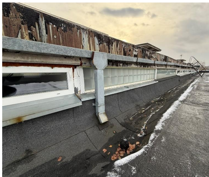
Pav. 18. Stogo defektai: apskardinimas pažeistas korozijos
