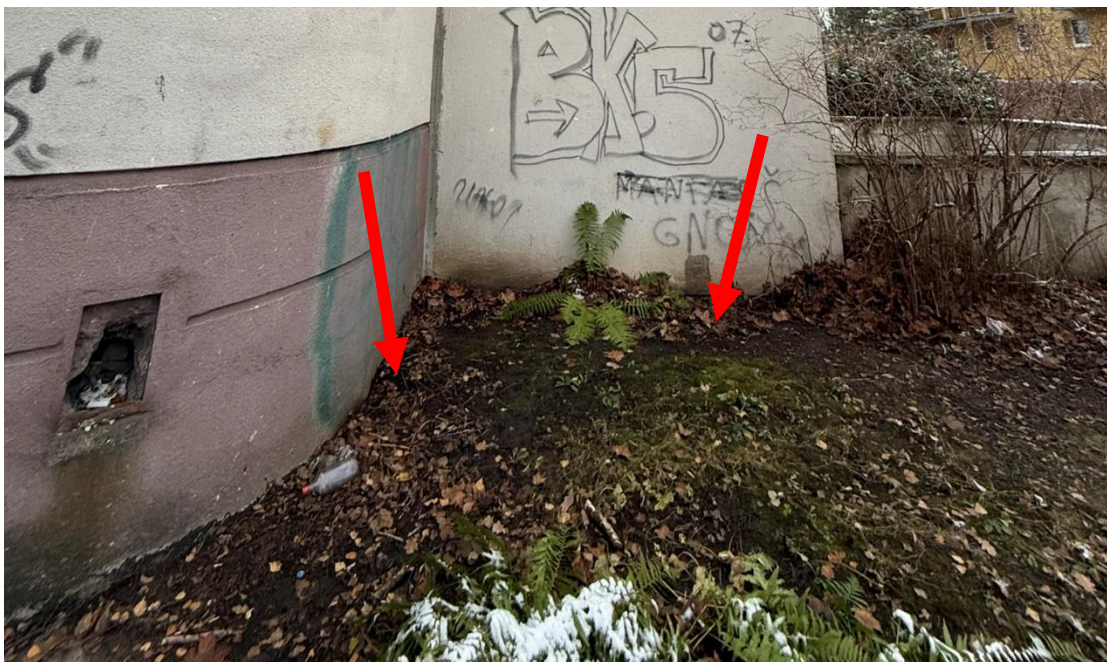
Pav. 9. Nuogrindos defektai
