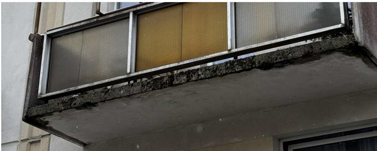
Pav. 22. Balkonų defektai: aptrupėjęs betonas
