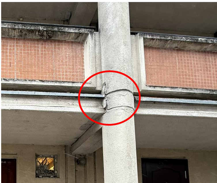
Pav. 15. Kolonų defektai: atskilęs betonas
