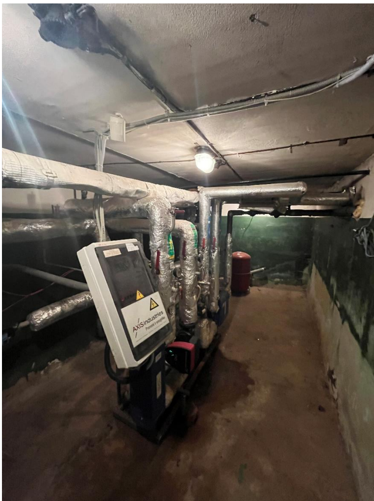
Pav. 23. Komunikacijų vamzdynų būklė
