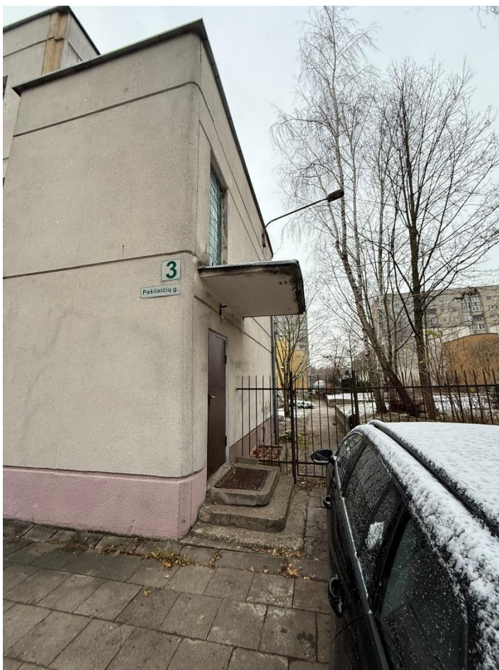
Pav. 19. Stogo defektai: bendra įėjimo būklė
