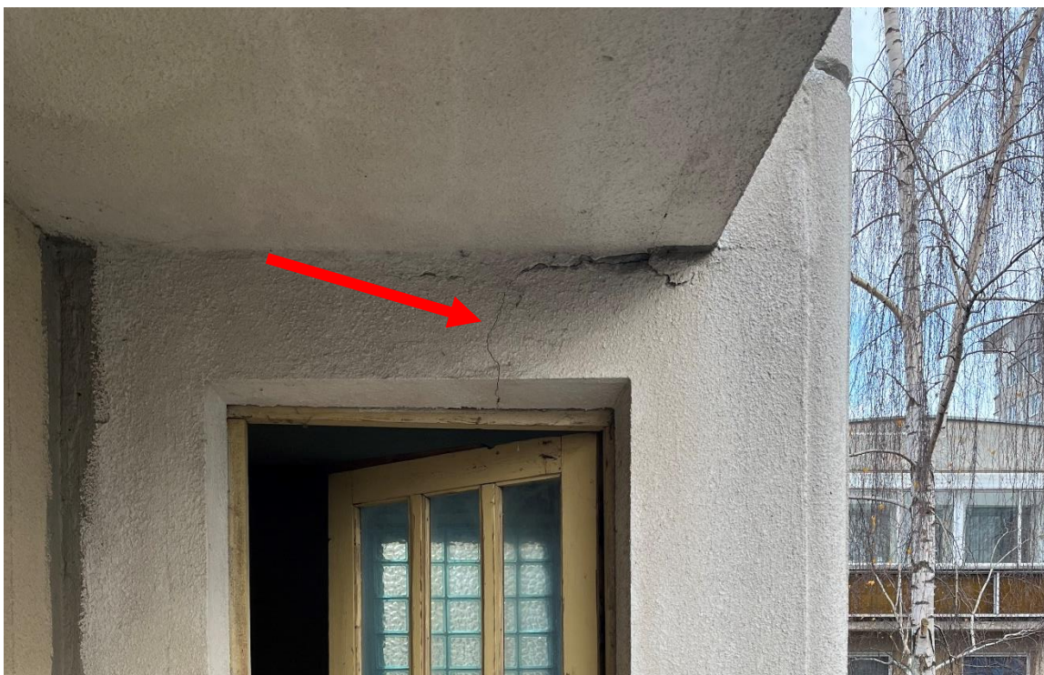
Pav. 10. Sienų defektai: vertikalus plyšys
