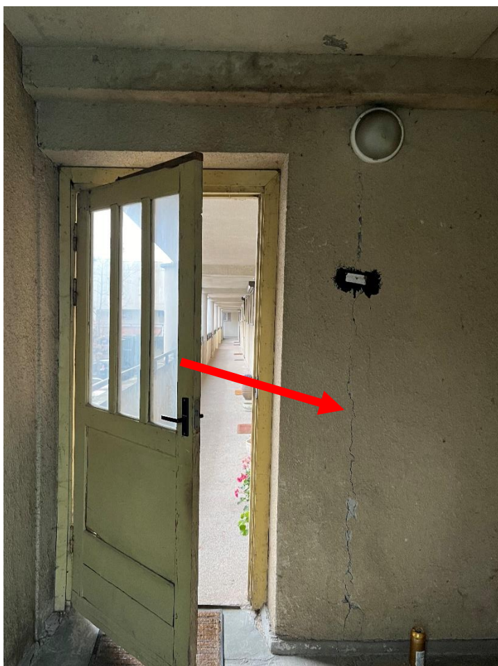
Pav. 11. Sienų defektai: vertikalus plyšys
