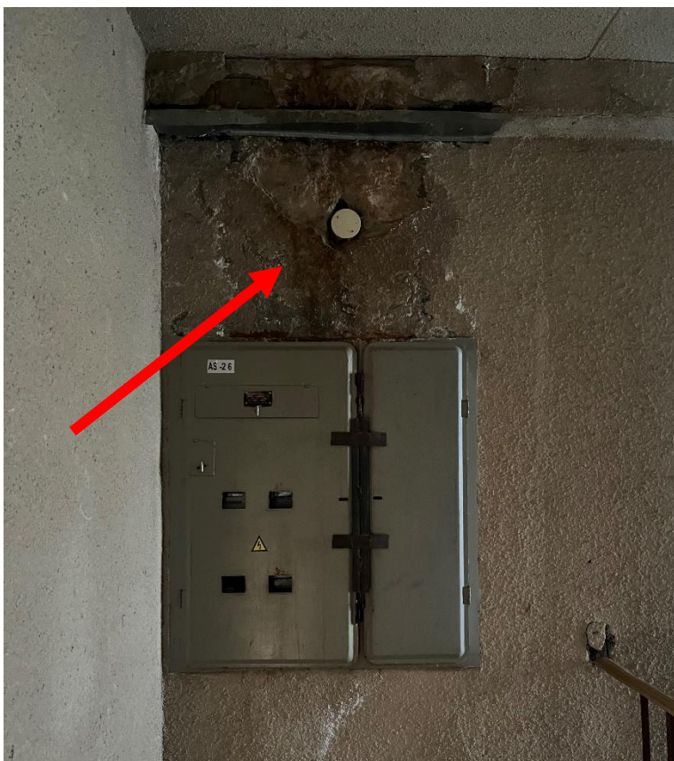
Pav. 13. Sienų defektai: aptrupėjęs betonas
