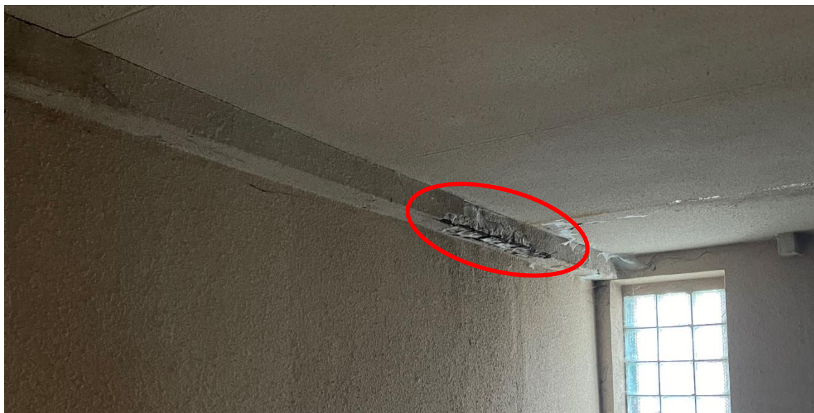
Pav. 12. Sijų defektai: pažeistas apsauginis betono sluoksnis
