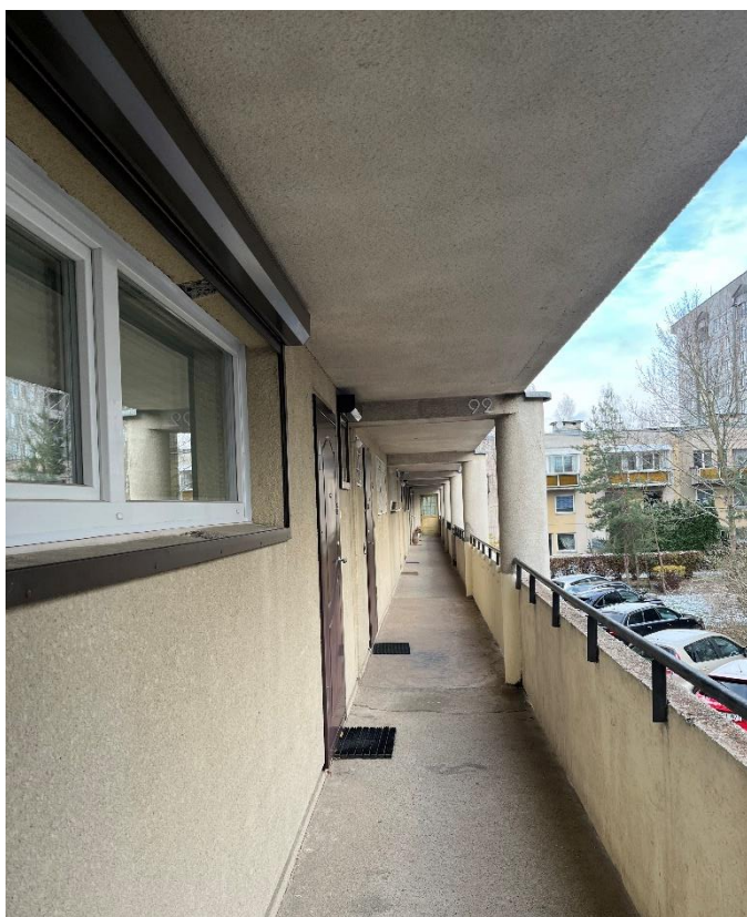
Pav. 14. Bendra galerijos būklė
