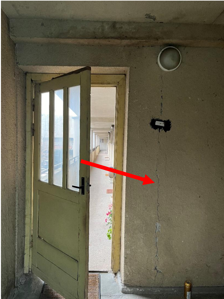
Pav. 11. Sienų defektai: vertikalus plyšys
