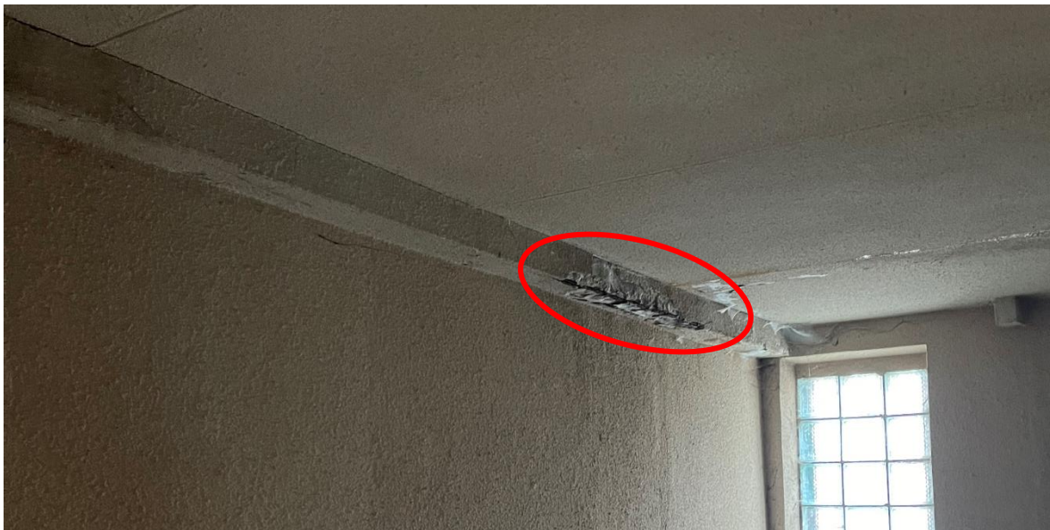
Pav. 12. Sijų defektai: pažeistas apsauginis betono sluoksnis
