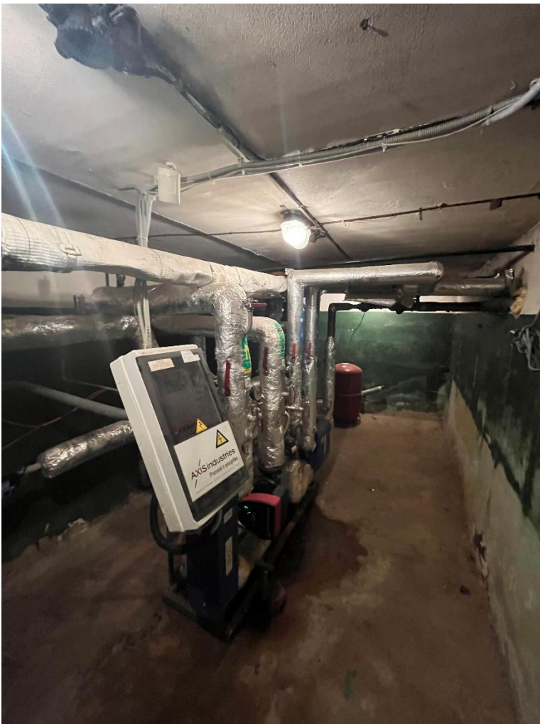
Pav. 23. Komunikacijų vamzdynų būklė
