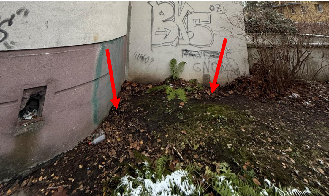
Pav. 9. Nuogrindos defektai
