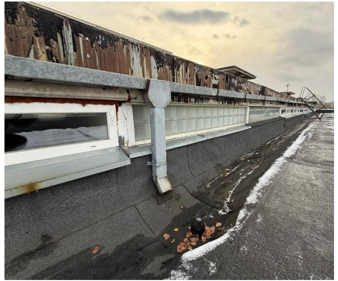
Pav. 18. Stogo defektai: apskardinimas pažeistas korozijos
