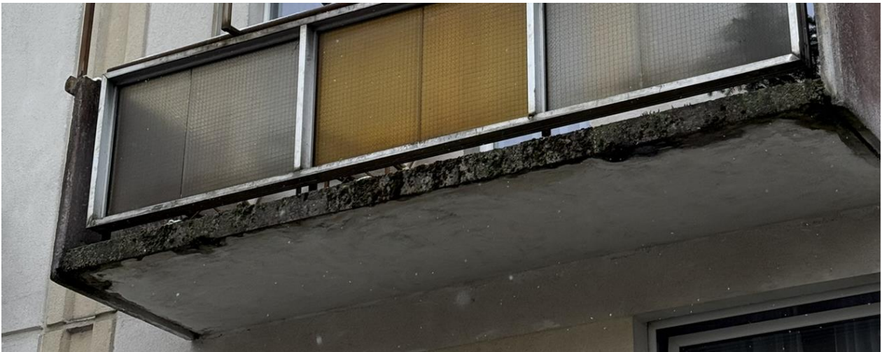
Pav. 22. Balkonų defektai: aprtrupėjęs betonas
