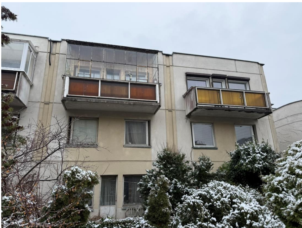
Pav. 20. Bendra balkonų būklė: kai kurie seni mediniai balkonai
