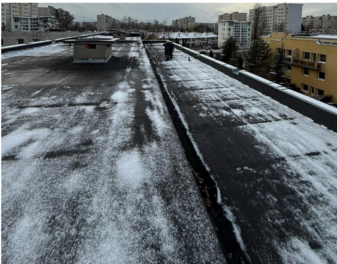
Pav. 16. Bendra stogo būklė
