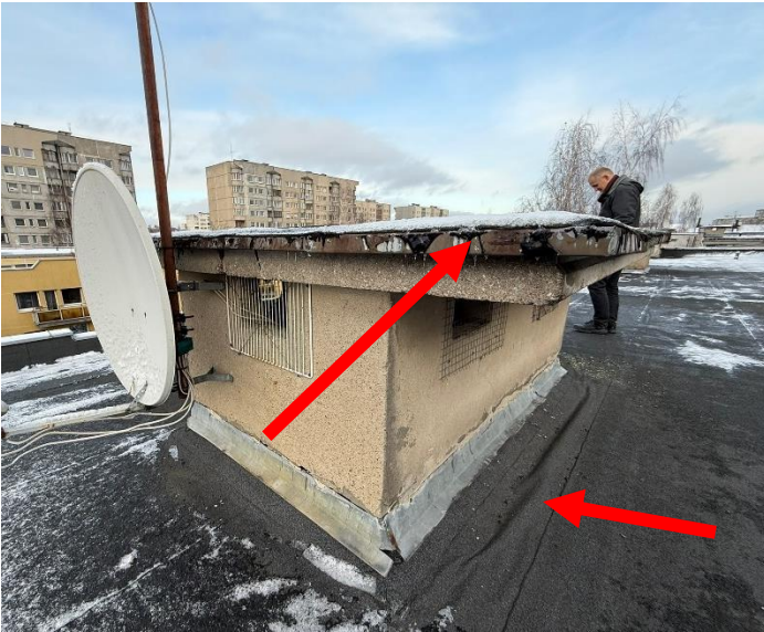
Pav. 17. Stogo defektai: apskardinimas pažeistas korozijos, pūslėta danga
