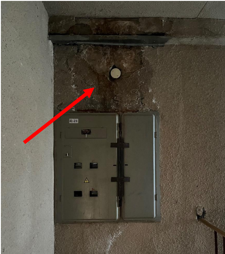
Pav. 13. Sienų defektai: aptrupėjęs betonas
