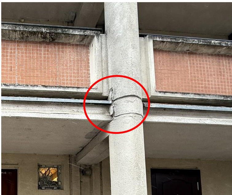
Pav. 15. Kolonų defektai: atskilęs betonas
