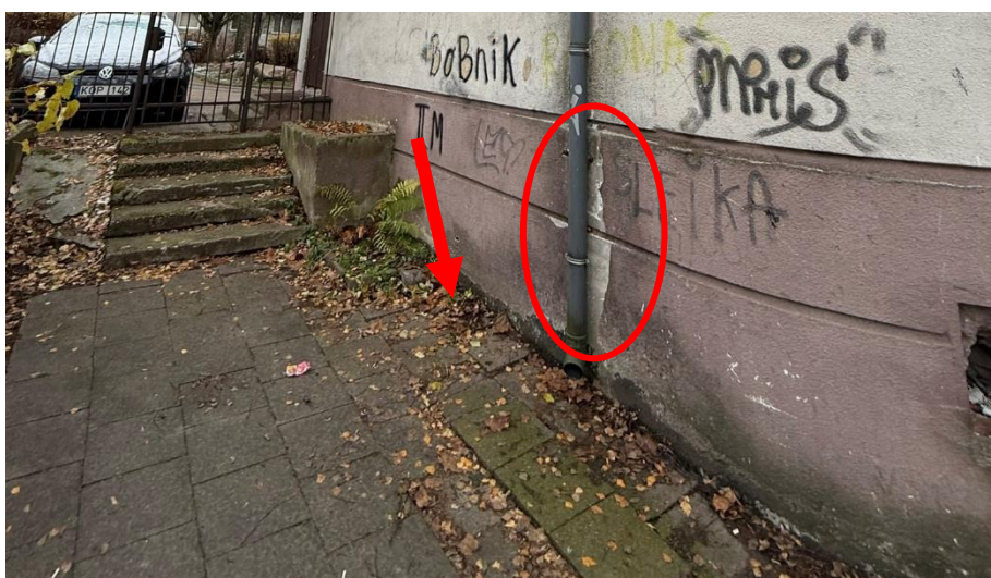
Pav. 8. Cokolio ir nuogrindos defektai
