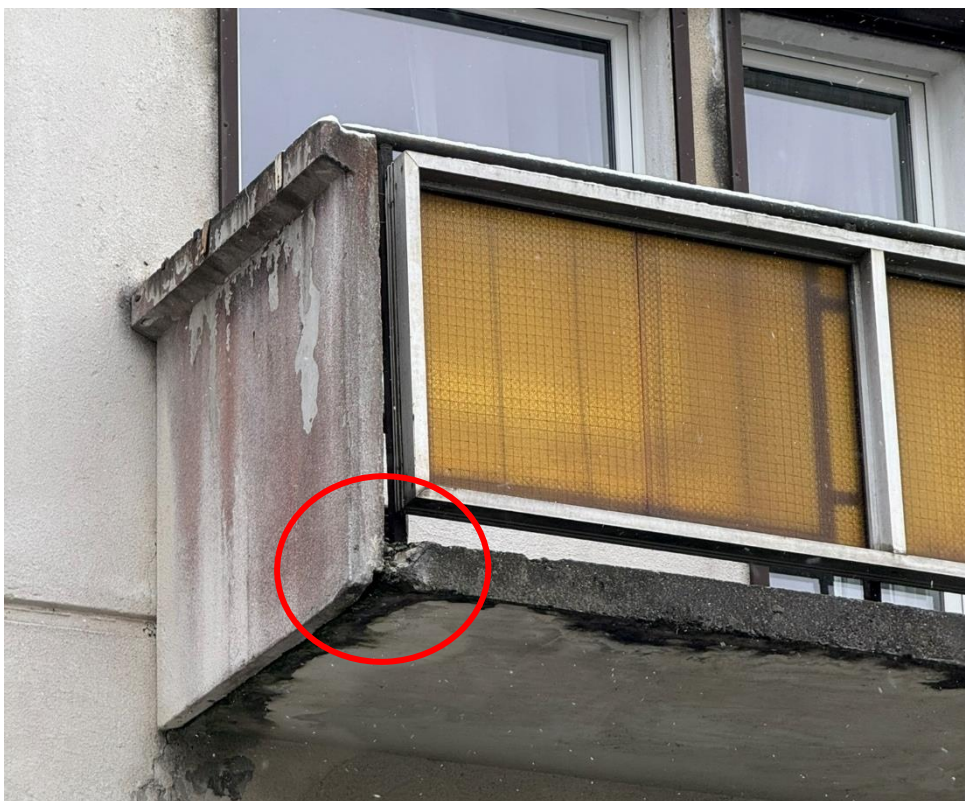
Pav. 21. Balkonų defektai: aptrupėjęs betonai
