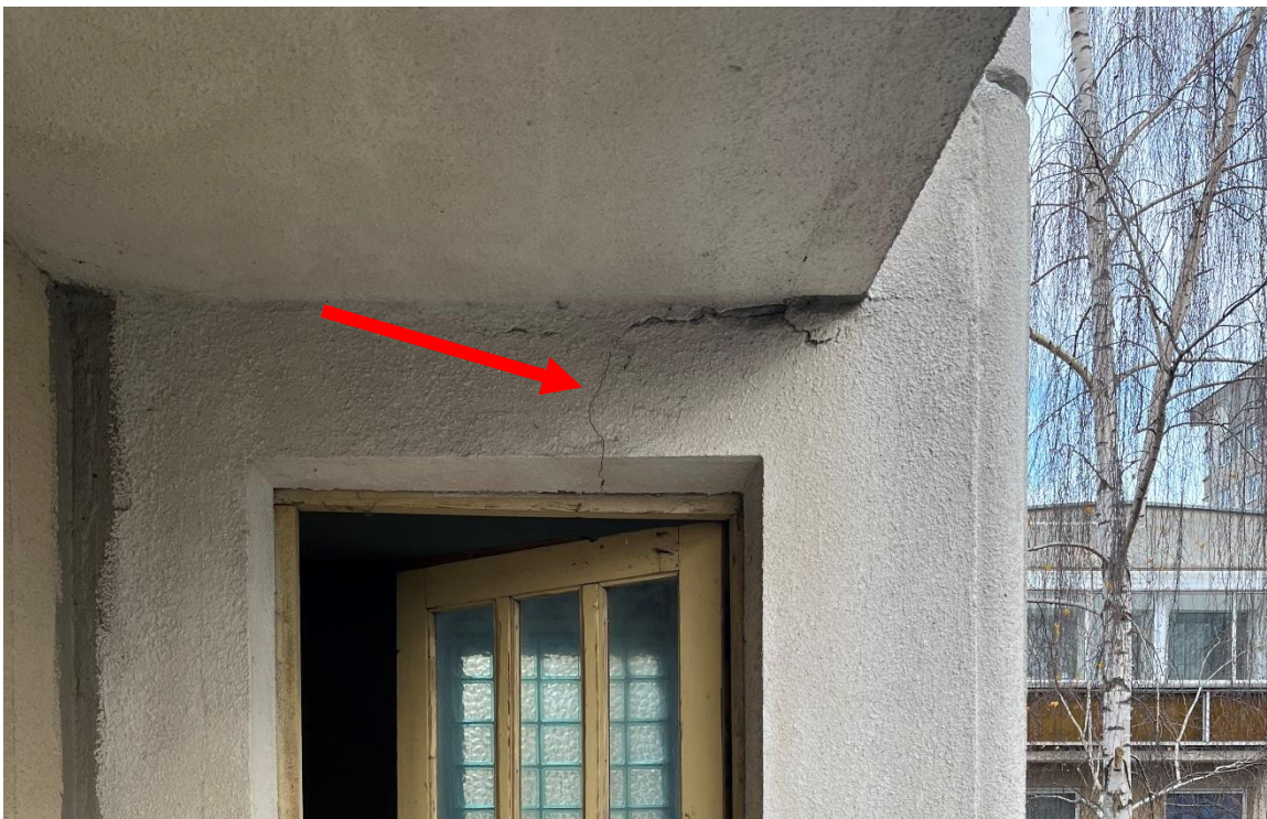
Pav. 10. Sienų defektai: vertikalus plyšys
