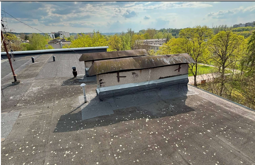
Stogas natūralios ventiliacijos kaminėliai
