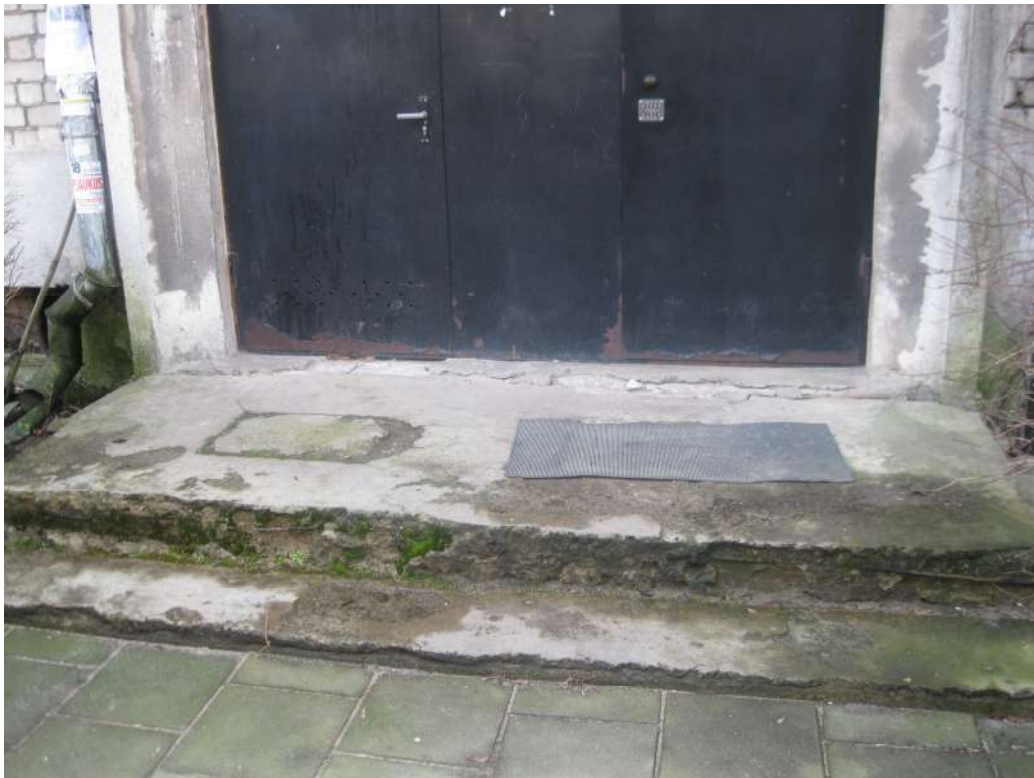
16 pav. Bendras vienos iš pastato įėjimo aikštelių vaizdas. Apsauginis betono sluoksnis vietomis suiręs, aptrupėjęs, matyti atsivėrusi armatūra, aikštelės paviršius nelygus.
