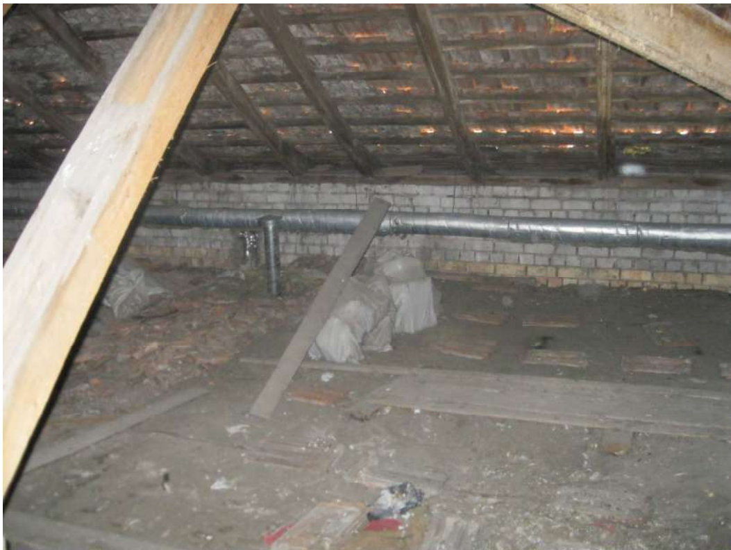
28 pav. Stogo danga vietomis nesandari, čerpės išdaužytos, ko pasekoje drėkinamos esamos laiknčios stogo konstrukcijos ir esamas palėpės apšiltinimas.
