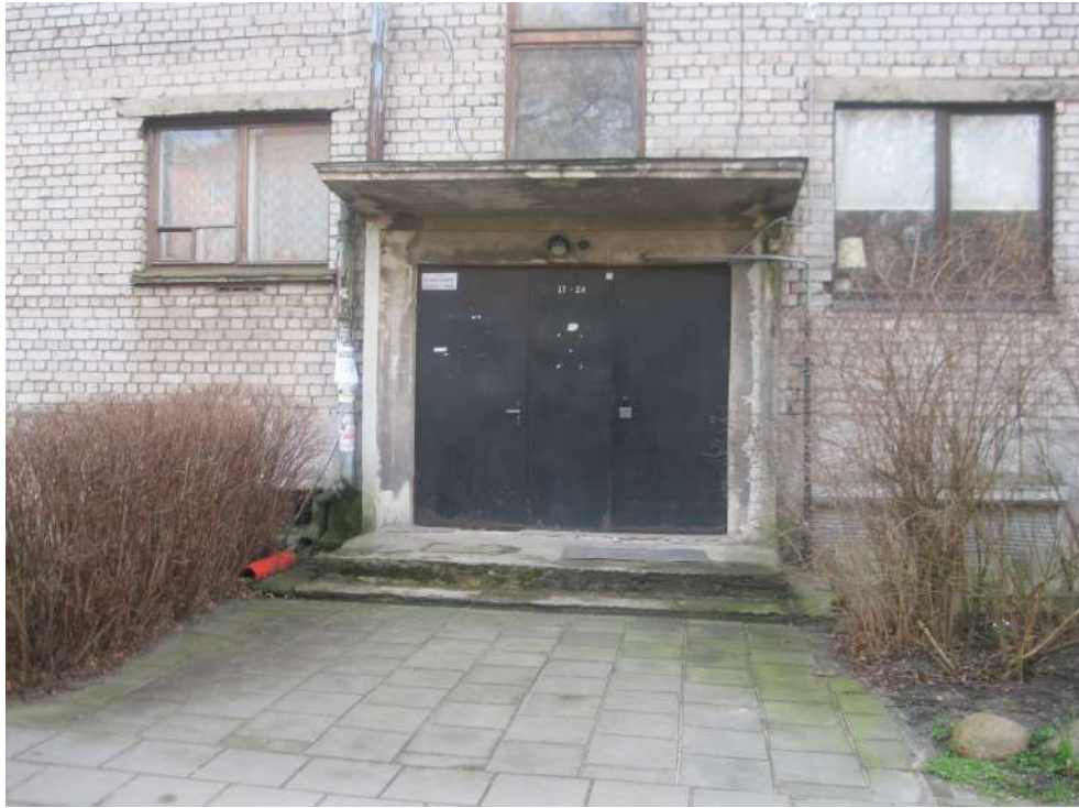
10 pav. Bendras vienos laiptinių lauko durų vaizdas. Durys jau pakankamai seniai pakeistos į metalines, todėl pastebėta šių durų korozija. Namų gyventojai nepritarė siūlymui duris keisti, todėl numatomas tik šių durų perdažymas derinant jų spalvą prie projektuojamo pastato fasado spalvinio sprendimo.
