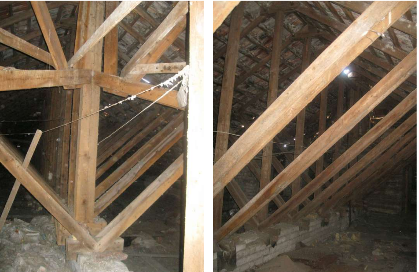
24 ir 25 pav. Šlaitinio stogo laikančių konstrukcijų būklė nėra bloga, tik vietomis pastebėti nedideli papuvimai. Būtinai šių konstrukcijų apsaugos nuo gaisro ir kenkėjų atnaujinimas (padengimas antiseptikais ir antipirėnais).
