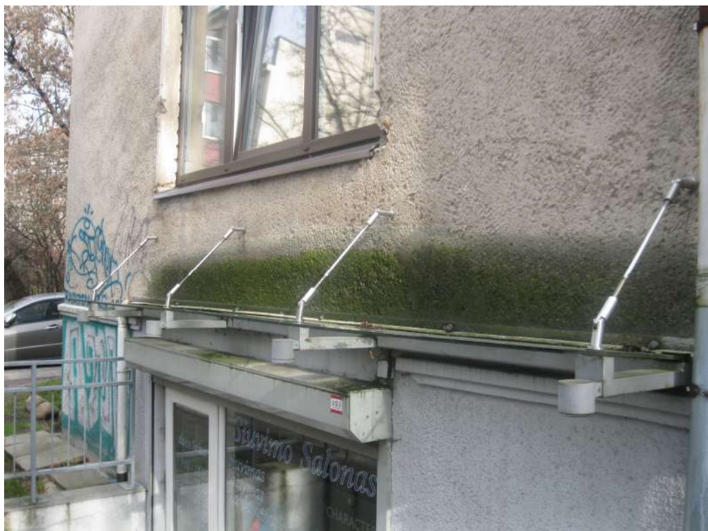
17 pav. Dėl neteisingai sumontuoto stogelio virš įėjimo į kūrybines dirbtuves drėksta virš jo esantis fasadas ir gadinama fasado apdaila
