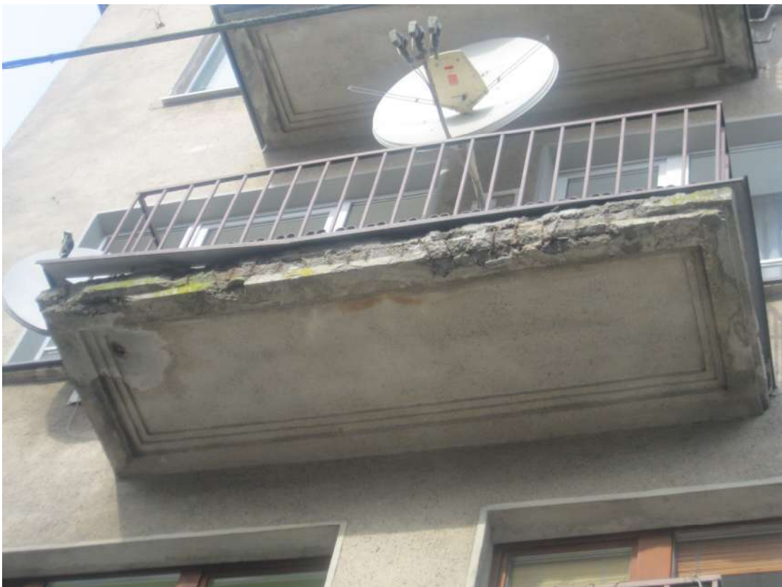
20 ir 21 pav. Kai kurių balkonų būklė prasta – apsauginis betono sluoksnis nukritęs, sunykęs, atsivėrusi armatūra pažeista korozijos; dėl neapskardintų balkonų kraštų nuolat drėkinama balkonų plokščių apdaila, ko pasekoje apdaila yra apsamanojusi.
