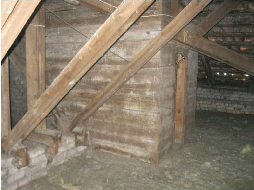
27 pav. Vietomis palėpę gyventojai apšiltinę akmens vatos plokštėmis, bet vėjo izoliacija nėra įrengta. Pro nesandarią stogo dangą pratekantis vanduo drėkina įrengtą apšiltinimą.
