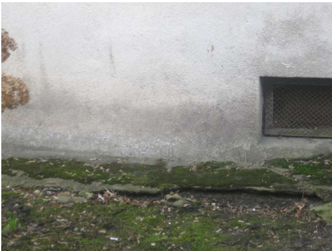
14 ir 15 pav. Bendras pastato nuogrindos vaizdas. Betoninė nuogrinda vietomis sunykusi, suskilusi, apsamanojusi. Šaligatvio plytelių nuogrinda išsikreivėjusi, pasvirusi į pastato pusę, tarp plytelių yra labai dideli tarpai.
